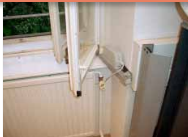
Illustration 2: Aktuatoren für motorbetriebene Fenster.
