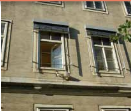
Illustration 3: Motorbetriebene externe Fensterrollladen in R3.
