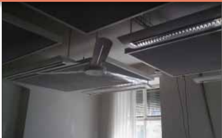
Illustration 4: Deckenventilator und abgehängte Decke mit Phasen-Wechsel Materialien. (PCM) in R3.
