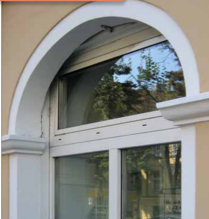
Kunststofffenster mit Rollladen, kein Bezug zur historischen Architekturöffnung. UPVC window with roller shutters, no reference to the historical architectural opening.
