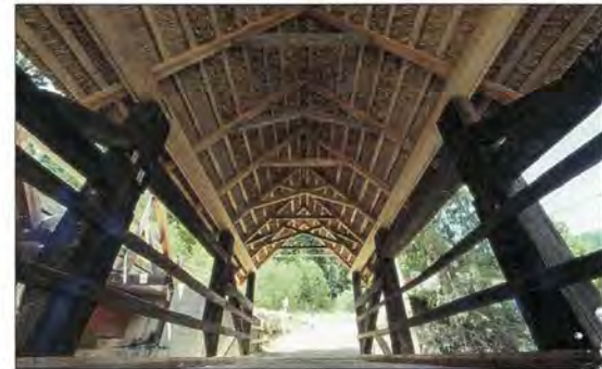
Die Untersicht in die Überdachung der Brücke zeigt den Wechsel in der Verstrebung der Sparren.
