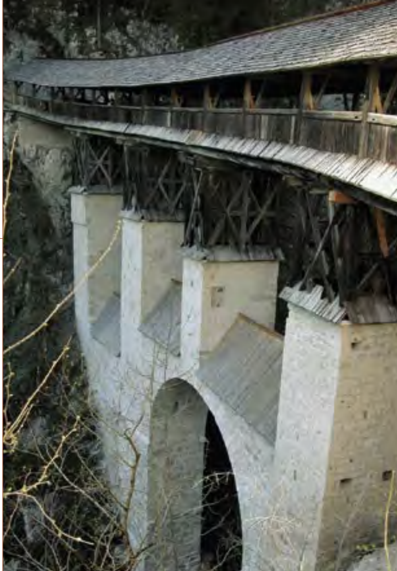
Die zur Zeit der Gotik errichtete Hohe Brücke von St. Georgenberg bei Stans nahe Schwaz in Tirol: Für die vorbildliche wissenschaftliche Untersuchung des Bestandes, die Dokumentation in Form detaillierter Baualterspläne und die Sanierung des wertvollen Bauwerks vergab die EUROPA-NOSTRA-Jury im Jahr 2005 eine Medaille. Foto: EUROPA NOSTRA
