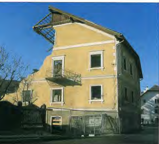
Gerichtsgebäude in Welsberg - vorher und derzeit (nach Beschlagnahme durch die Behörde unklar, ob es endgültig abgerissen wird).
