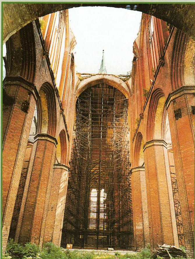
Durch Luftangriffe 1945 schwer beschädigt, verfiel die gotische St. Georgenkirche in Wismar mangels möglicher Baupflege. 1990 wurde mit dem Wiederaufbau begonnen, mehr als 14 Millionen Mark stellte allein die Deutsche Stiftung Denkmalschutz zur Verfügung.
